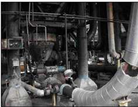
吹气扩容蒸汽管道
