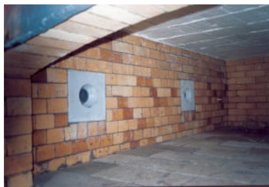
图 2b.窑炉内部的耐火炉墙以及烧嘴砖 (BEE, 2005)
